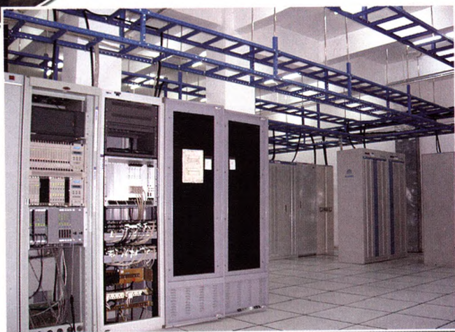
▶ 电信通信机房
