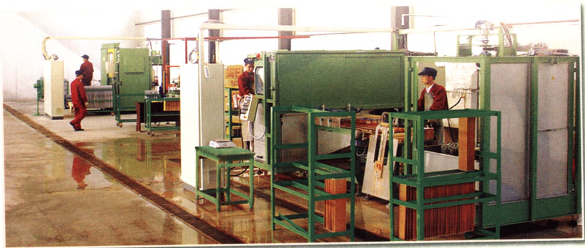
▲ 蓄电池生产车间
